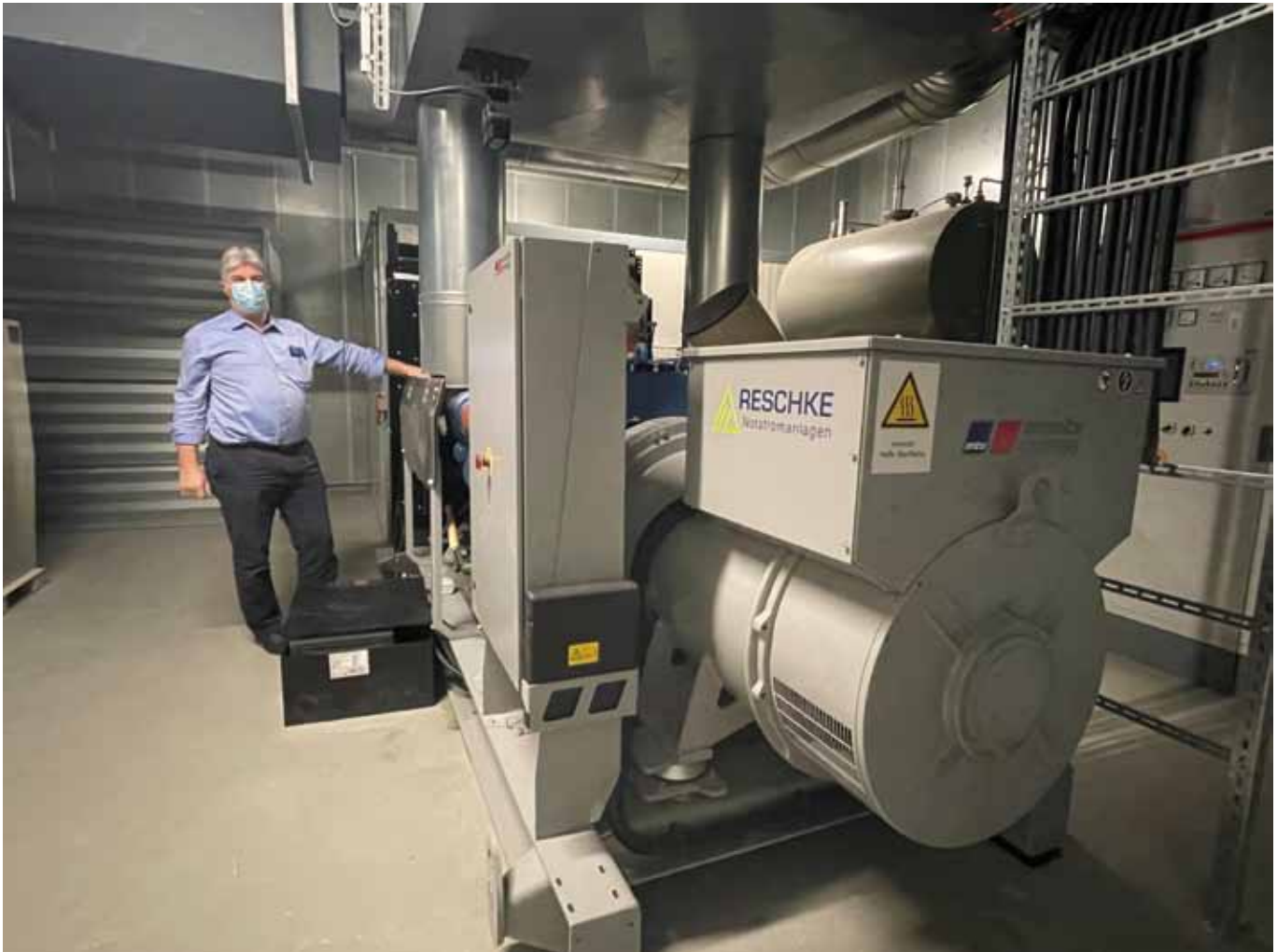
Technikchef Horst Wettermann vor dem größten der mehreren Generatoren, die im Klinikum Kulmbach dafür sorgen, dass auch bei einem Stromausfall alles reibungslos weiterläuft.
