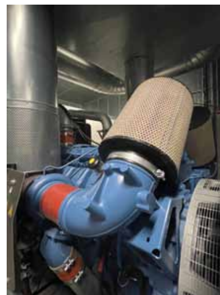
Ein Blick auf Details der hochkomplexen Anlage, die dafür sorgt, dass im Kulmbacher Klinikum das Licht nicht ausgeht.
