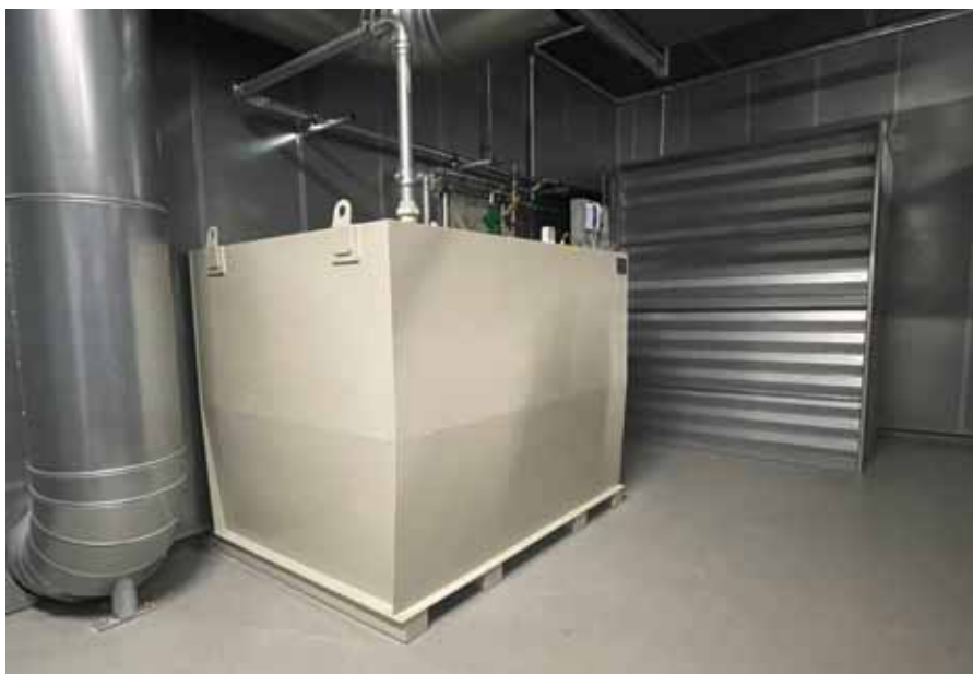
5000 Liter fasst allein der Dieseltank, der das riesige Aggregat im Neubau speist.
