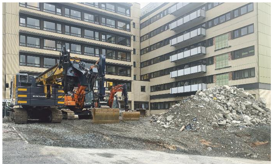
Die Spezialmaschinen, mit denen die Bohrpfähle gesetzt werden, haben Mitte Januar mit ihrer Arbeit begonnen.
