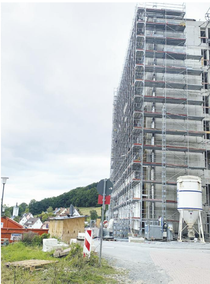
Schon bald wird auch der letzte Teil des Gerüsts verschwinden. Der neue Bettenbau soll bereits zum Jahreswechsel bezogen werden.
