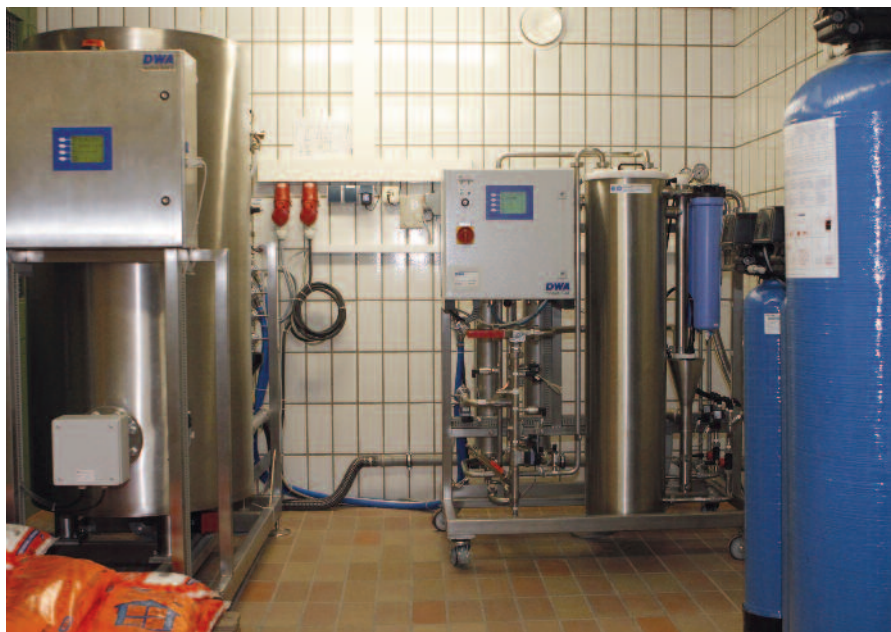
Die neue Osmose-Anlage des Klinikums ist installiert und in Betrieb genommen. Sie ist mit dem höchsten hygienischen Standard ausgestattet.
