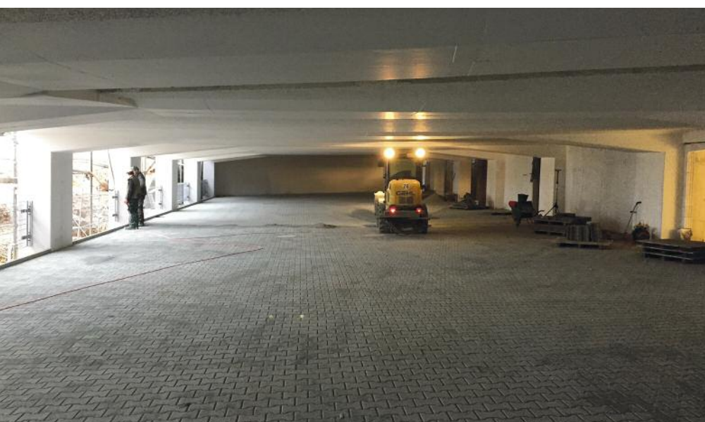
Der Boden auf der Ebene -2 ist schon fertig gepflastert. Noch in diesem Jahr, so hoffen die Verantwortlichen, sollen die ersten Fahrzeuge die neue Garage nutzen können.
