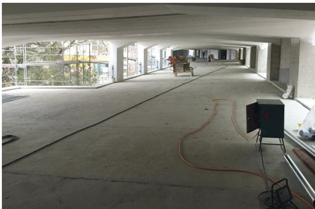
Langsam nimmt es Gestalt an, das neue Parkhaus. Die Ebene -1 ist bereits fertig betonierte und wird mit einem Spezialbelag beschichtet.
