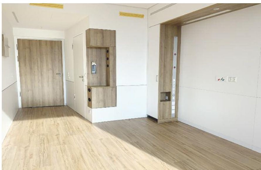
In den neuen Patientenzimmern, die alle auf Zweibettstandard ausgelegt sind, ist der Ausbau bereits weit fortgeschritten. Holzoptik wird bei der Gestaltung für ein warmes Ambiente sorgen.
