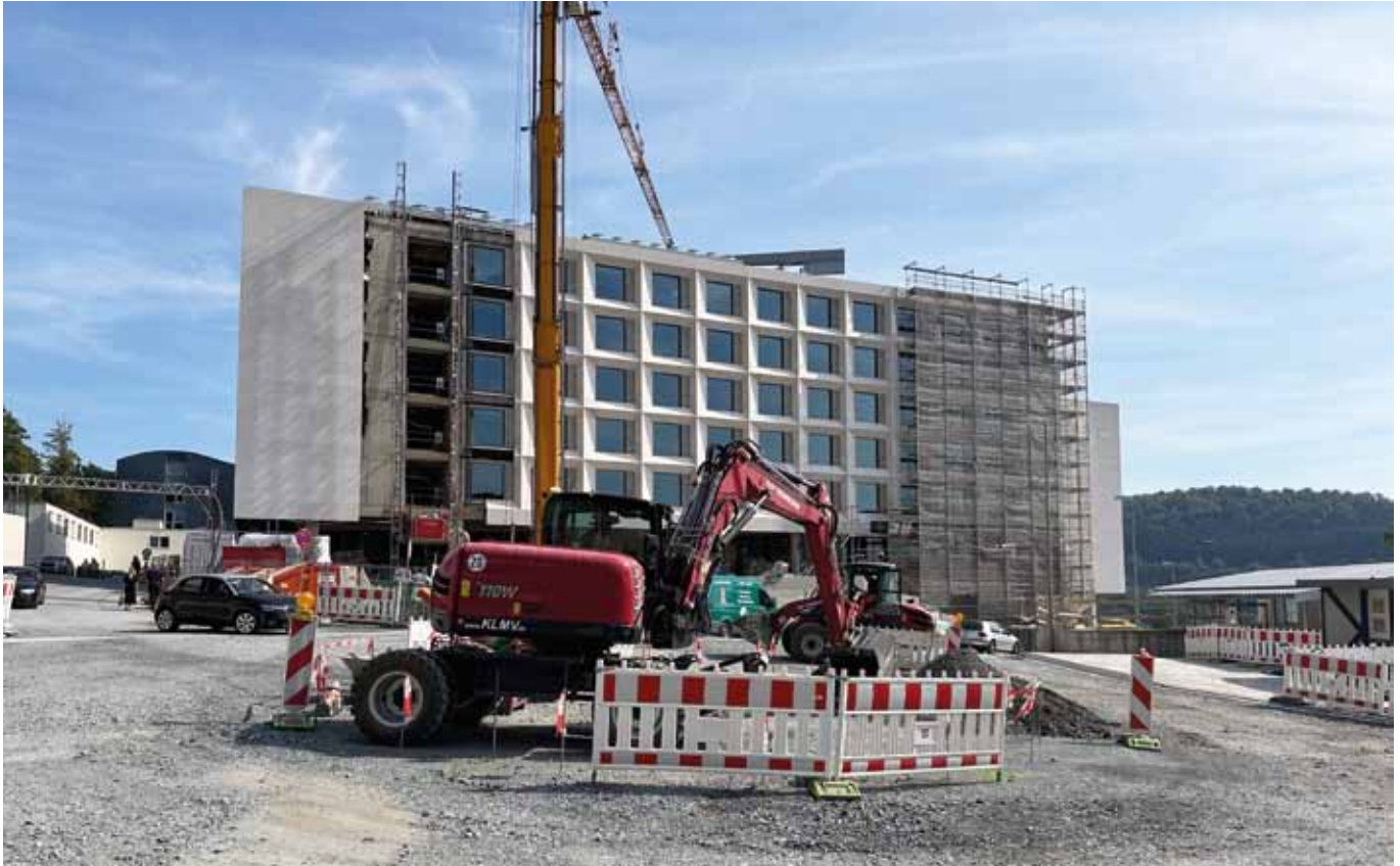
In großen Schritten geht der Erweiterungsbau am Klinikum Kulmbach voran. Derzeit wird sowohl am Neubau West als auch am Wendehammer vor dem Klinikum mit Hochdruck gearbeitet. Foto: Klinikum Kulmbach
